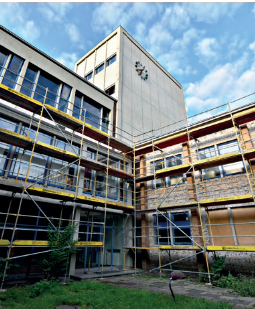
Im Turm befinden sich riesige Tanks, in denen das Wasser aus zwei Tiefbrunnen gesammelt wurde. Im Zuge der Sanierung wird das Paracelsus-Bad erstmals ans Berliner Wassernetz angeschlossen.
